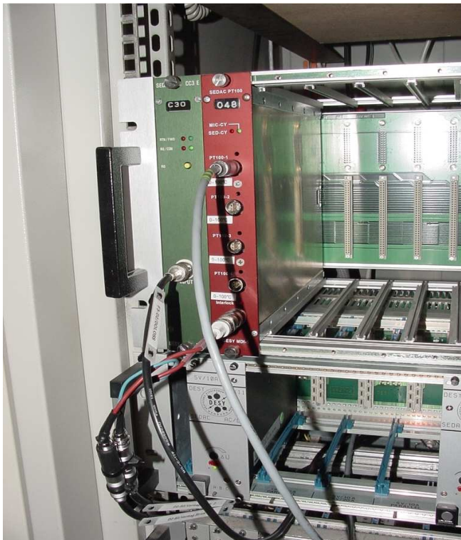
Abbildung 6, Temperaturüberwachung des Peakingstrip-Sensors (SER-D2)
