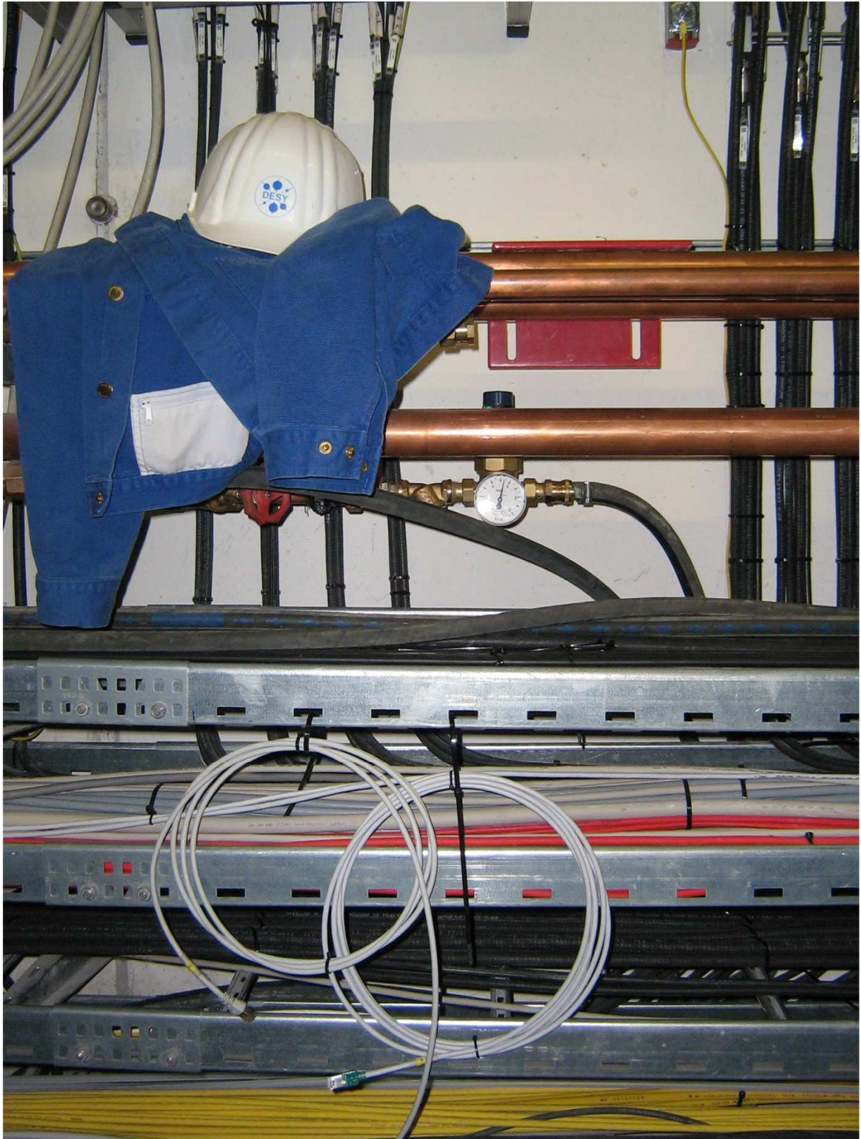
Kabelpritsche Position für RJ45 Kupplung(Verbindung Dosi-Box Dump mit TCA Crate)
